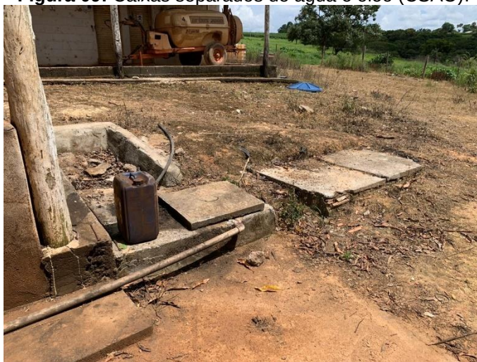
Figura 09: Caixas separados de água e óleo (CSAO).
